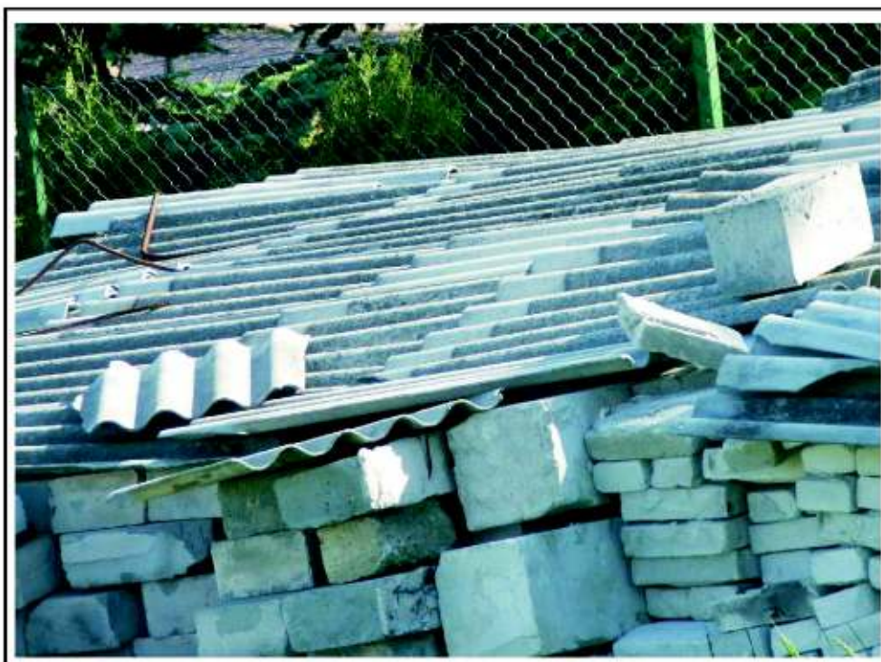
Fot.6 Zniszczone płyty faliste na terenie posesji - I stopień pilności
