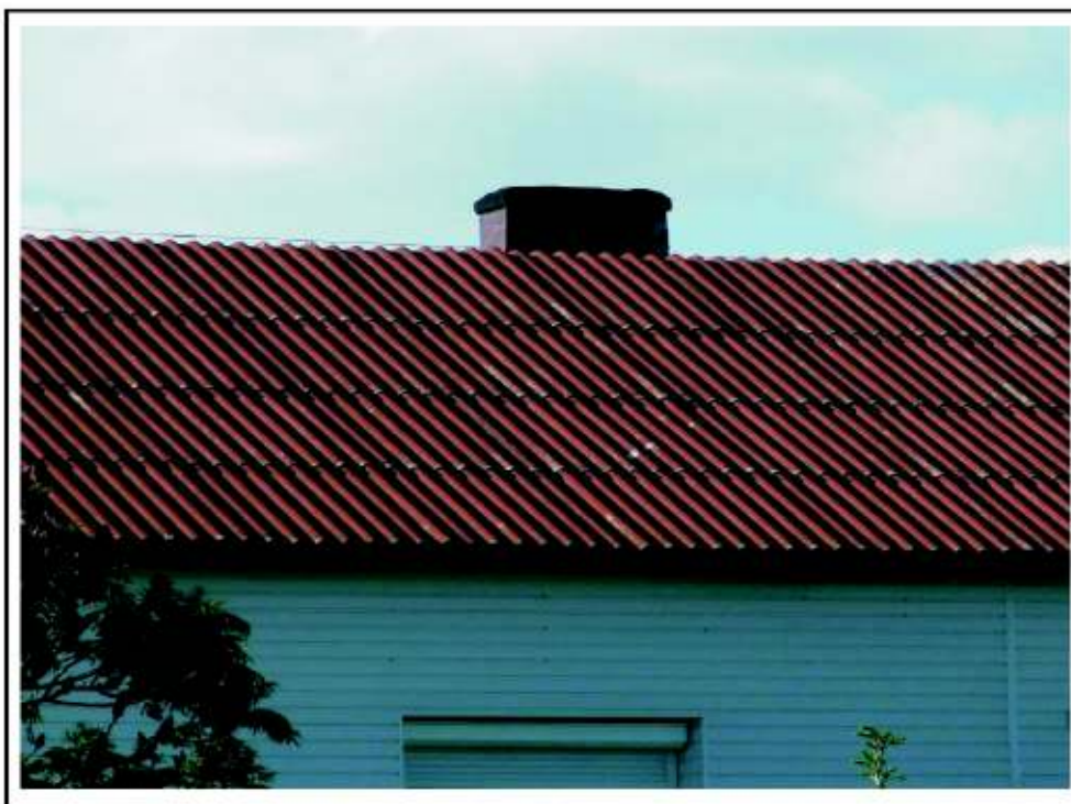
Fot.4 Pokrycie dachowe budynku mieszkalnego z płyt falistych - III stopień pilności
